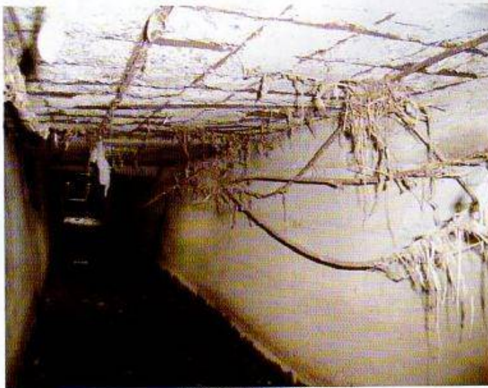
暗渠のヒビ割れ調査
